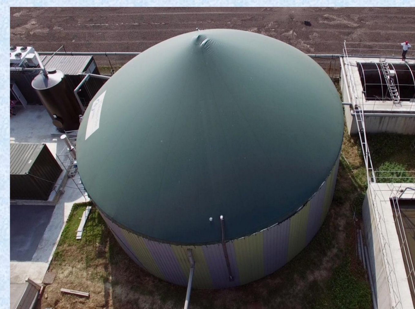
圖2. 能源廠設置之直立式發酵槽。
