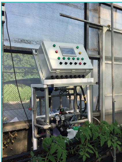
說明：無線灌溉控制系統主機
